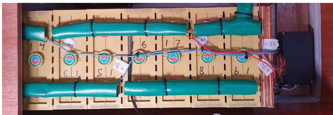
200Ah batteribank av Winston LFP celler i en 2P4S konfiguration.
