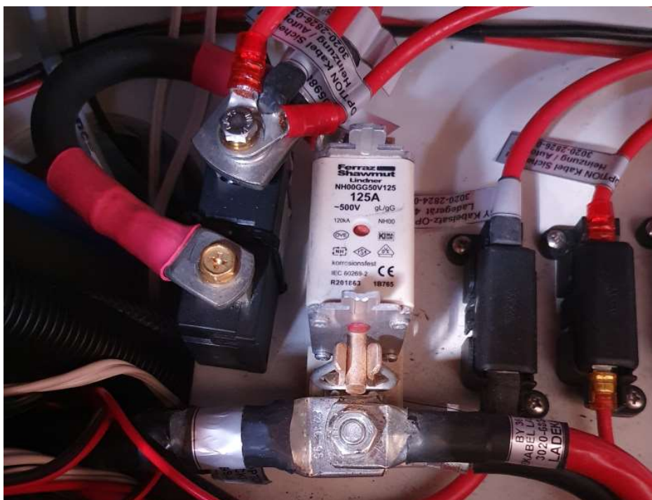
Ett bistabilt 100 A relä installerat bredvid huvudsäkringen.
