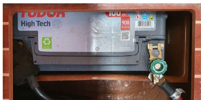
100 Ah backup batteri.
